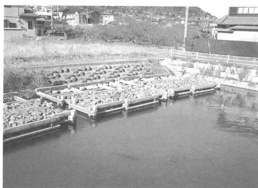
図4. 自然配慮としての石組護岸。その本来の目的は達成していない（岐阜県海津市）。
